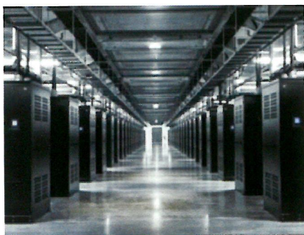
数据中心 Data center
